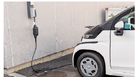
JAほくさいに設置されたEV充電設備
